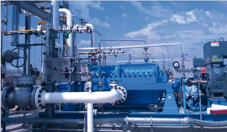
Sulzer Ethanpumpe in einer NGL-Fraktionierungsanlage in Houston/Texas. Pumpe und Dichtung laufen seit der Umrüstung auf die innovative Dichtungslösung EagleBurgmann DFDGS6 im Jahr 2011 störungsfrei.
